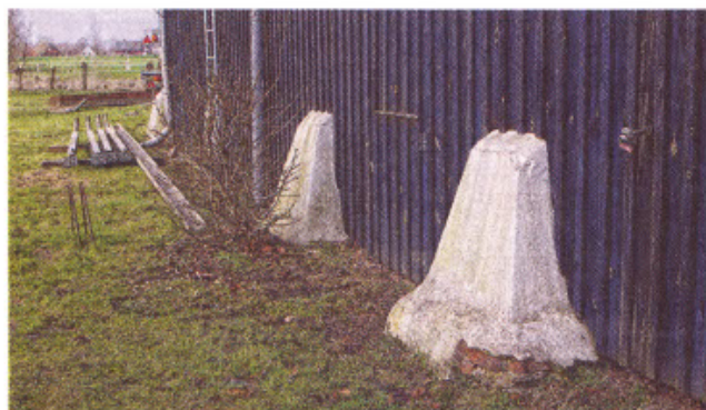
Die 100 Jahre alten Punkt-Fundamente könnten zusätzliche Lasten einer Sanierung nicht tragen.
